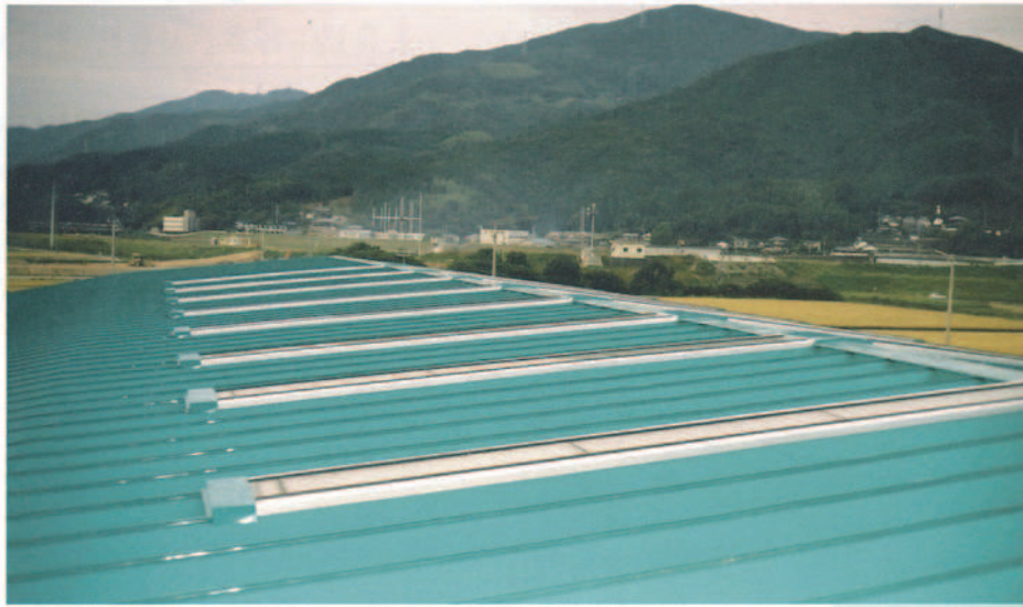
パチンコ店での設置事例(愛媛県大洲市)
